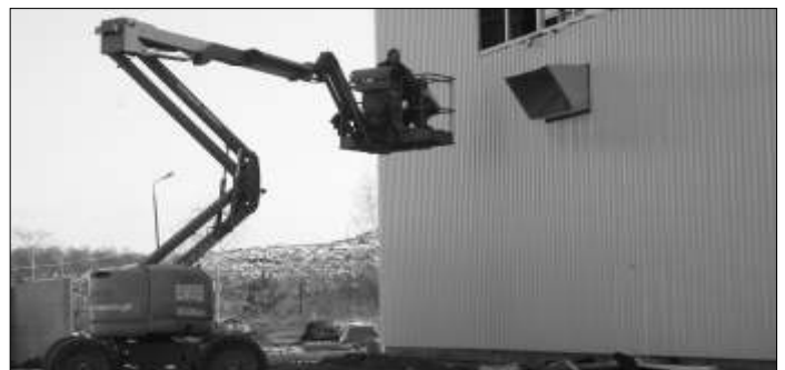
Trwa warta 15 milionów złotych budowa stacji segregacji odpadów w Czarnówku. Pozyskane środki zewnętrzne to ok. 8 mln zł.
